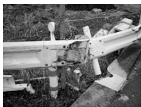
壊れたガードレール
